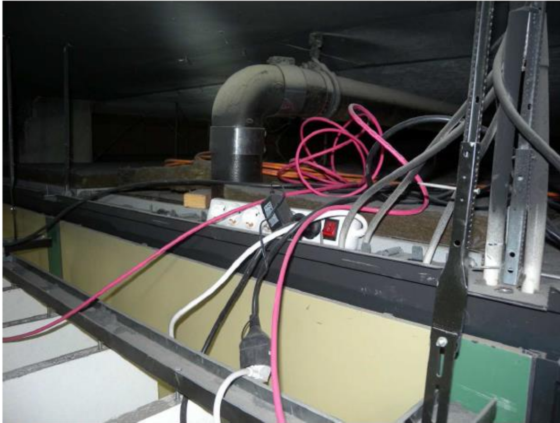
Bild 6 Blick auf die Rasterdecke von der Flurseite aus, einschließlich der vorhandenen Kabel und einer Rohrdurchführung
