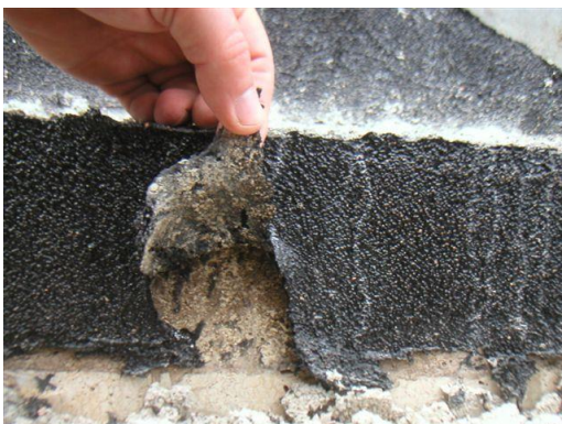
Bild 1: Exemplarische Schadensfeststellung TÜV SÜD: Abziehbares PMBC Material mit Zementschlämme ohne Untergrundhaftung
