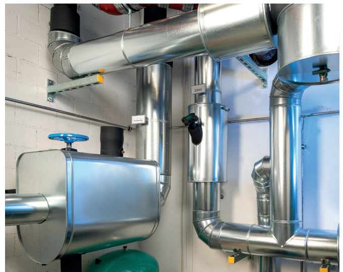
Abb. 1: Rohre, Armaturen und Speicherbehälter dürfen nur so viel Trinkwasser enthalten, wie für die Versorgung technisch erforderlich ist | Bild: TÜV SÜD
